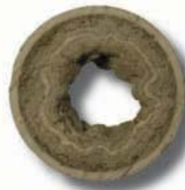
Трубопроводы для охлаждающей воды после менее чем года работы без фильтрации.
